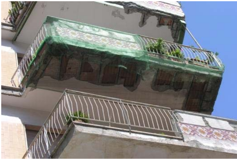
Degrado dei materiali...
