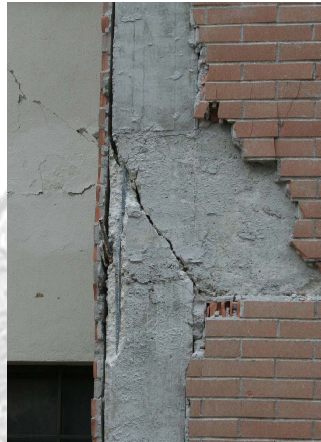
Instabilità armatura pilastro passante nel n
